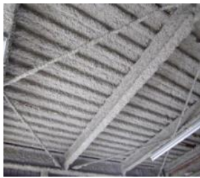
(図1) 天井に吹き付けられたアスベスト
